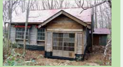
改修後の旧開拓家屋。崩れていた玄関部分も復元された。
